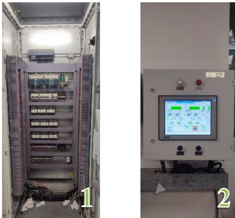
1 – Оборудование шкафа управления с ПЛК; 2 – Панели оператора
