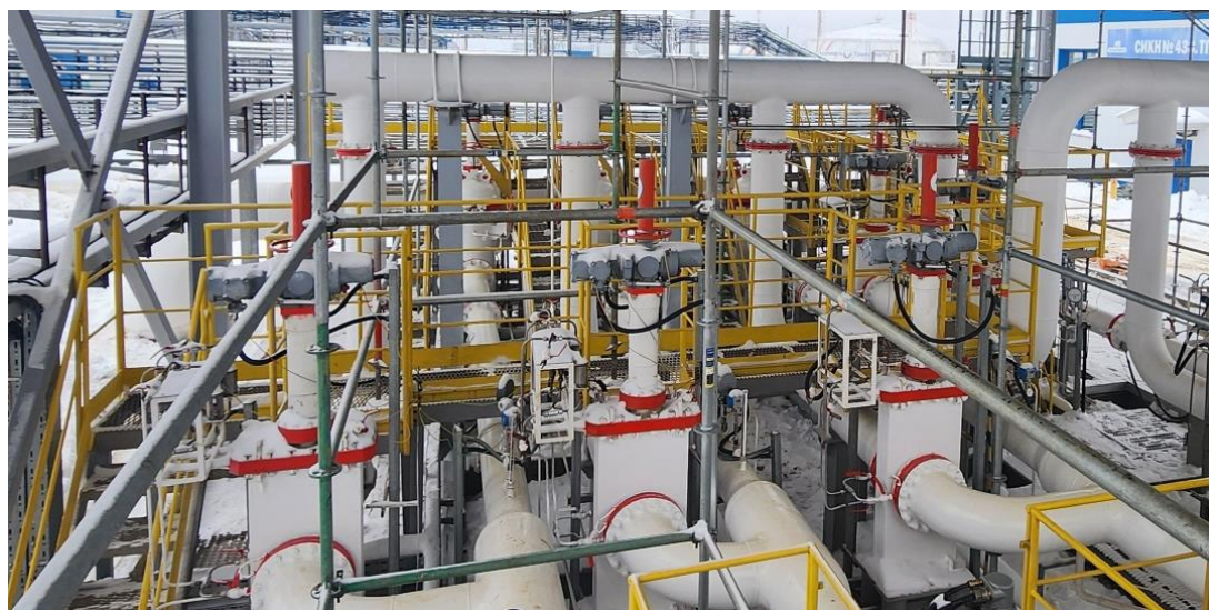
Рисунок 1 – Общий вид СИКН
