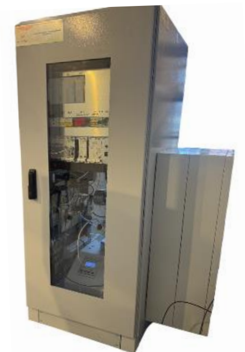
а) шкаф газоаналитический (времяпролетный масс-анализатор)
