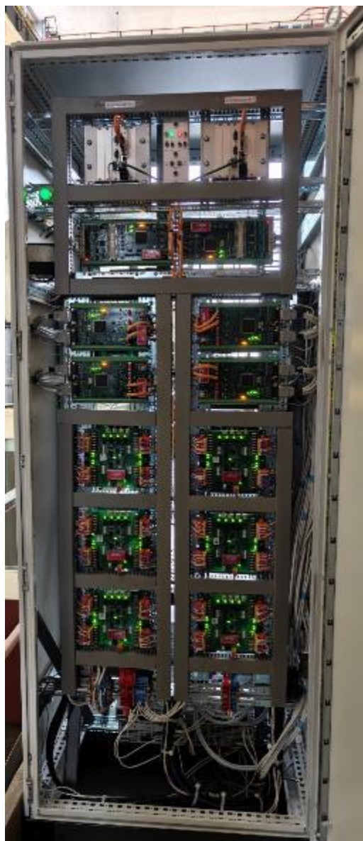
Рисунок 2 – Общий вид промышленного шкафа ИК СИКОН СУБА (вид сзади)
