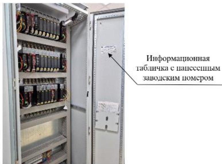
Рисунок 1 – Общий вид контроллерного шкафа комплекса
