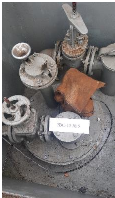
Рисунок 2 – Горловина резервуара РВС-15 зав.№ 5
