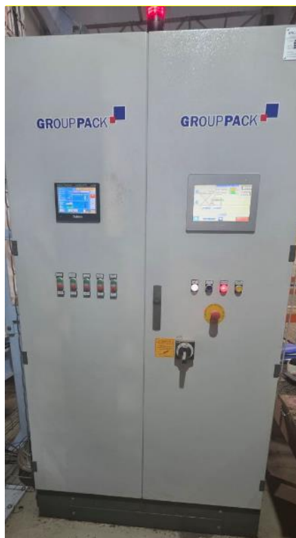
Рисунок 2 – Общий вид узла управления
