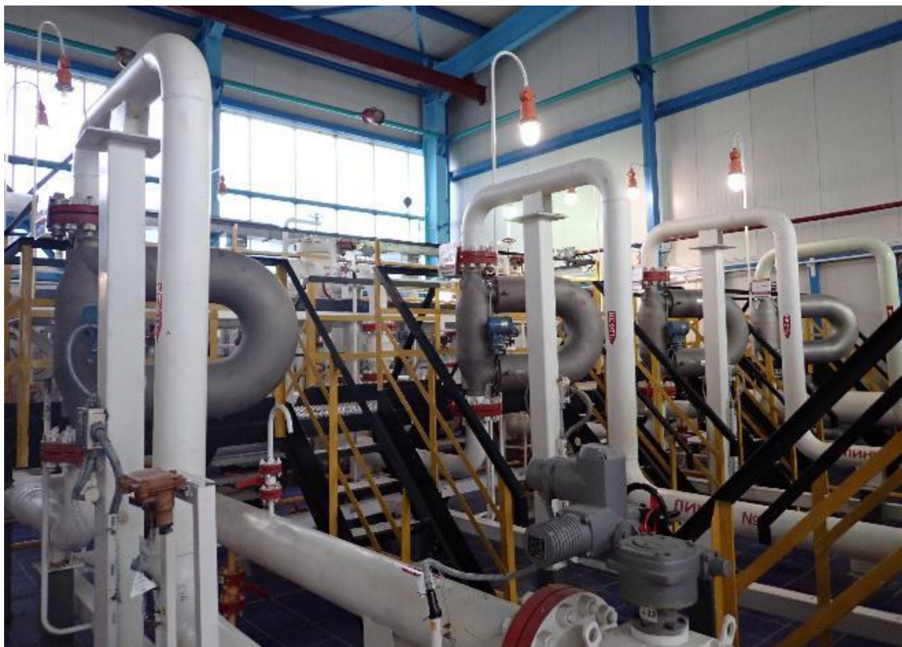
Рисунок 1 – Общий вид СИКН
