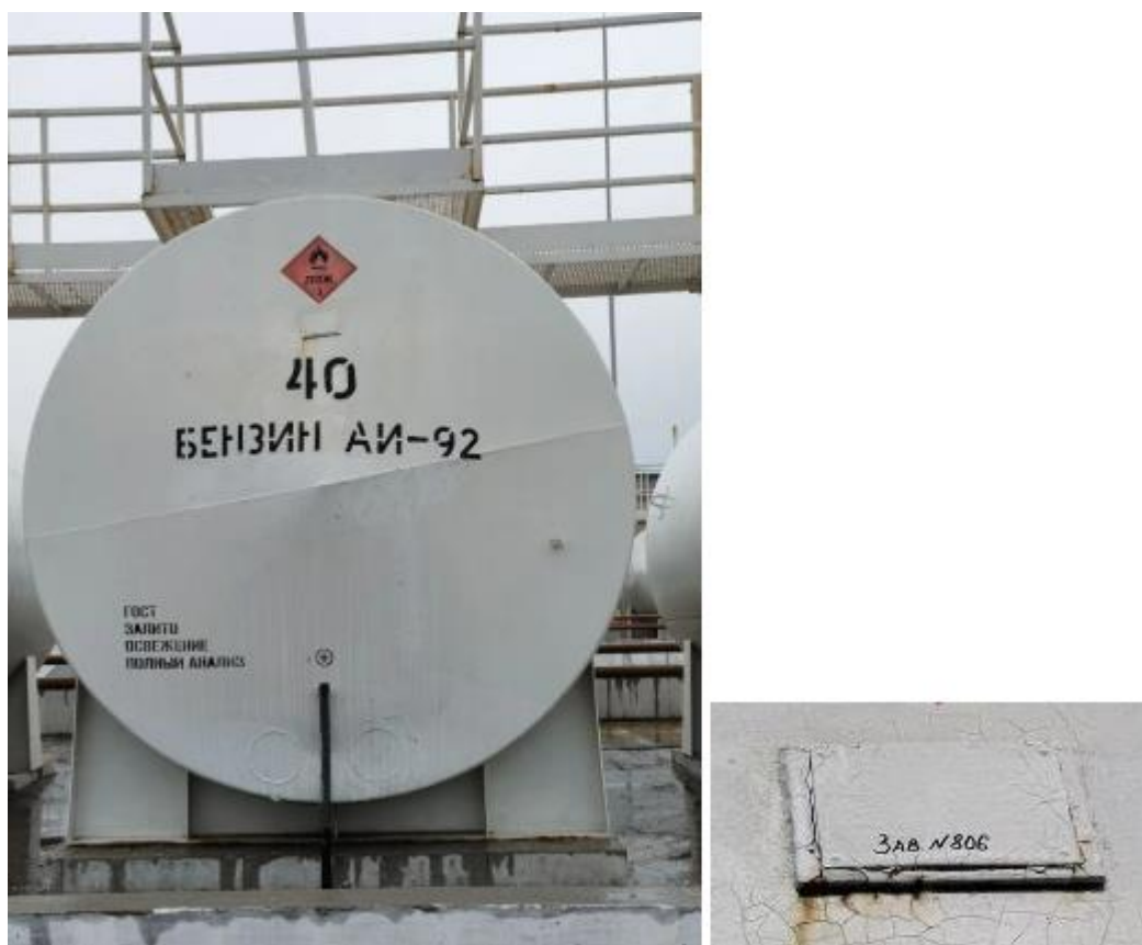
Рисунок 3 - Общий вид резервуаров РГС-25 зав. № 806 с местом нанесения заводского номера Пломбирование резервуаров РГС-25 не предусмотрено.
