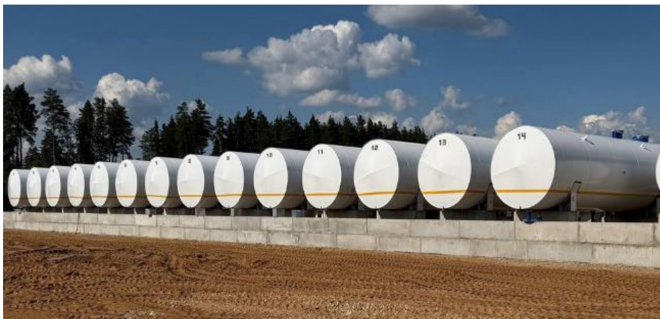
Рисунок 2 – Общий вид резервуаров РГСн-50
