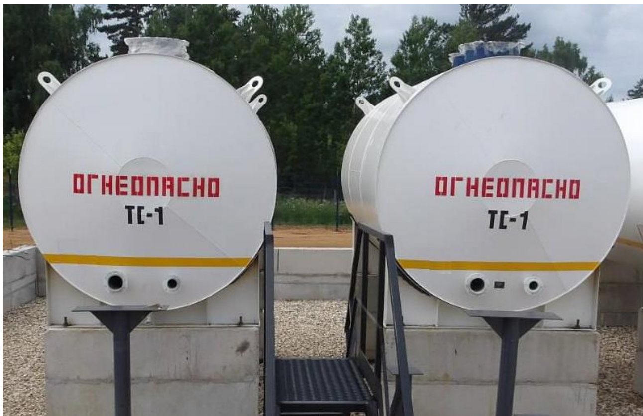
Рисунок 2 – Общий вид резервуаров РГСН-25
