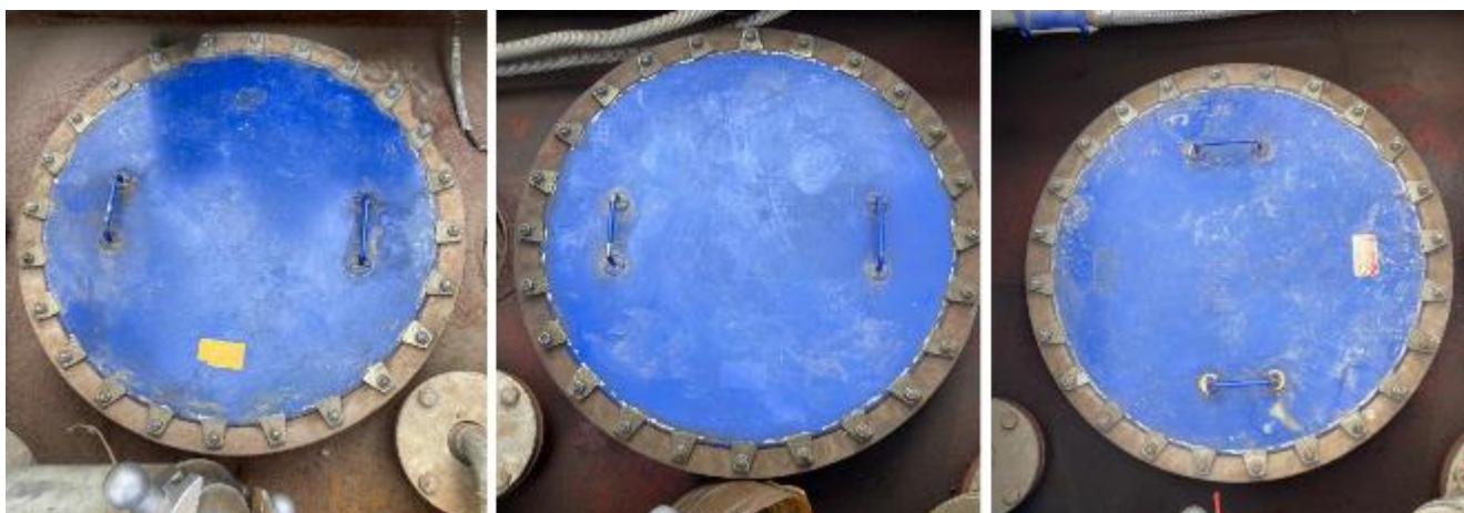
Рисунок 3 – Горловины резервуара РГД 40(13,3+13,3+13,3) зав.№ 1552
