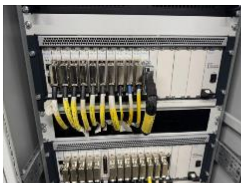
Рисунок 9 – МПС-236 в стойке приборной АИИС. Вид внешний
