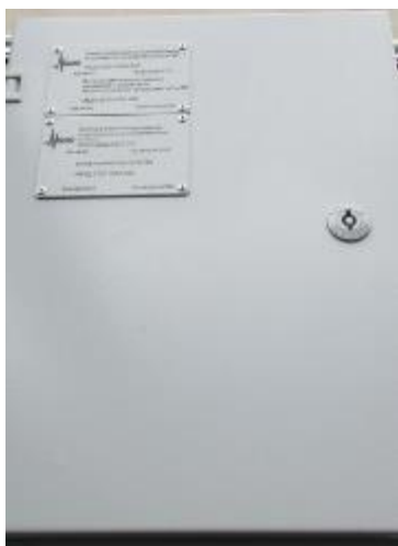
Рисунок 11 – Шкаф нормализаторов ШН2. Вид внешний
