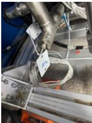
Рисунок 13 – Термометр сопротивления ТС716 в месте установки.
