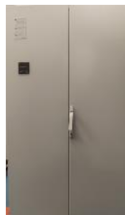
Рисунок 6 – Шкаф кроссовый АИИС. Вид внешний
