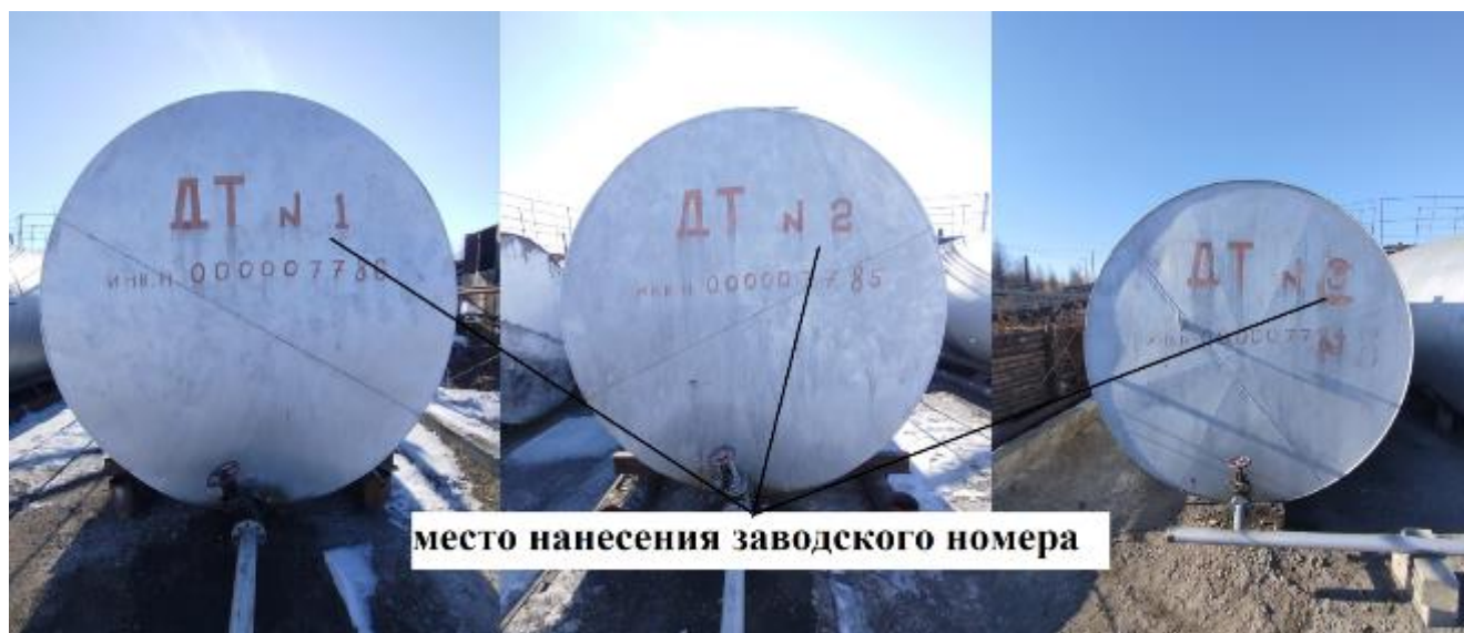
Рисунок 1 – Общий вид резервуаров РГС-50
