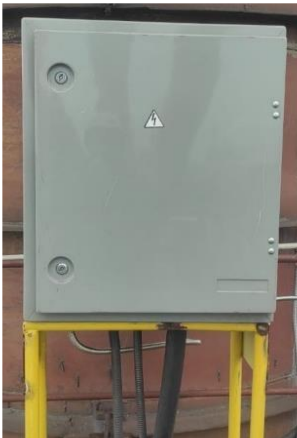
Рисунок 3 – Общий вид обогреваемого пробоотборного шкафа с газоотборным устройством
