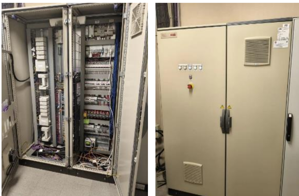
Рисунок 2 – Общий вид шкафа вторичной части ИК ИС
