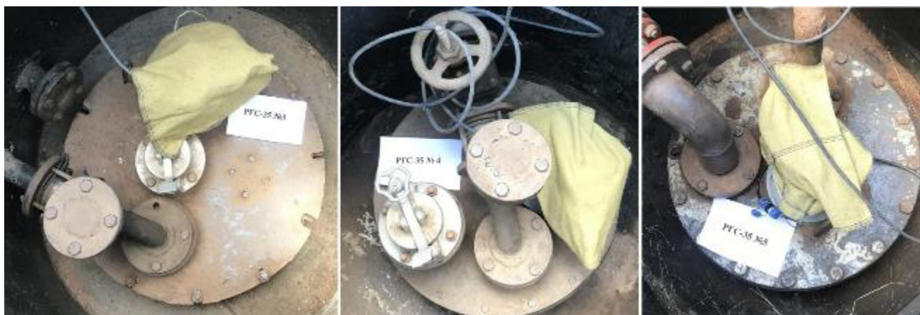
Рисунок 2 – Горловины резервуаров РГС-35 зав.№№ 3, 4, 5
