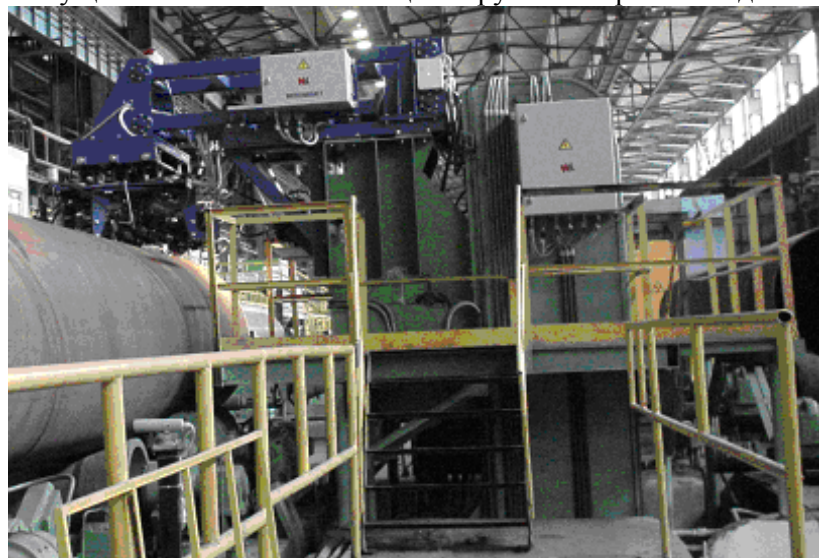
Рисунок 1. Общий вид установки.
