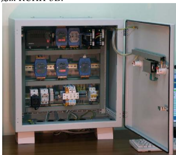
Рис. 1. Шкаф управления КСИП-3
