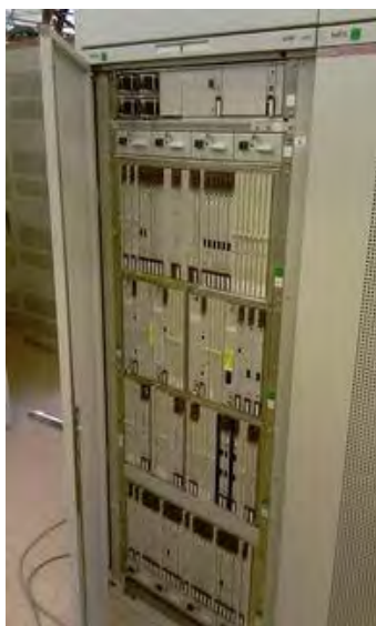
Рисунок 1- Общий вид оборудования с открытой дверью
