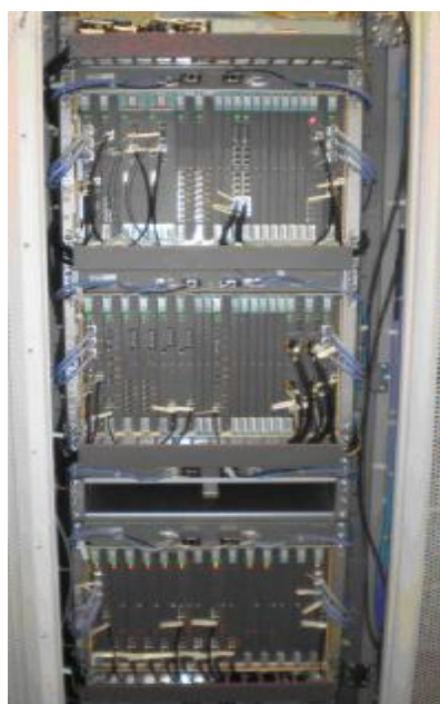
Рисунок 1 Общий вид оборудования с открытой дверью
