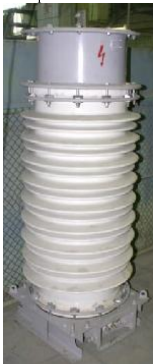
Рисунок 1 – Фотография общего вида трансформаторов напряжения НКФ-110-06
