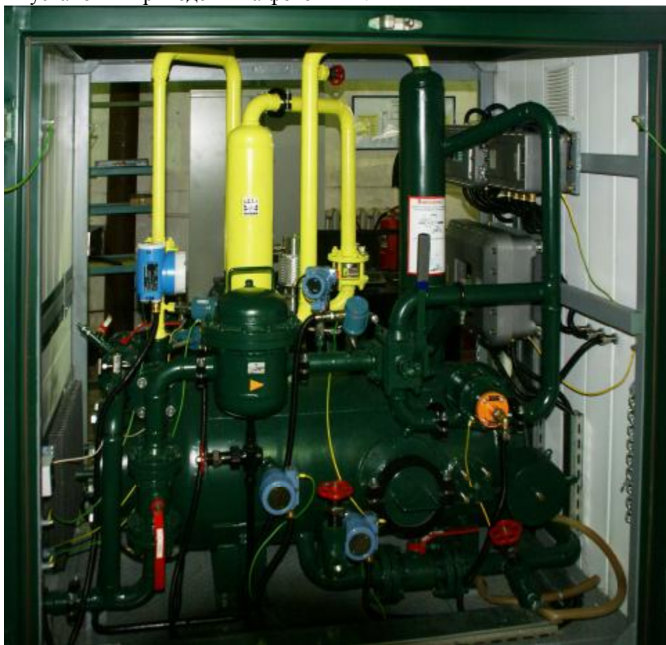
Фото 1 - Фотография установки измерительной ЦИКЛОН
