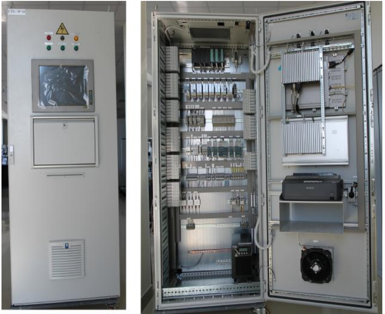
Рисунок 2. Внешний вид шкафа СТК-ЭР-М
