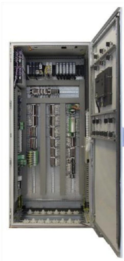
Рисунок 1 – Внешний вид шкафа контроля и управления цехом СКУ КЦ РИУС
