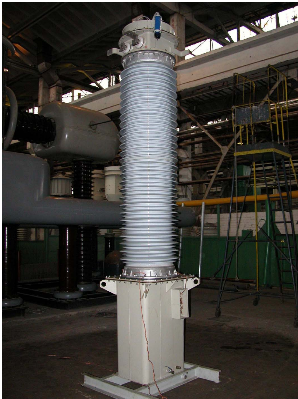
Рис.2 Трансформатор тока ТФБ 220
