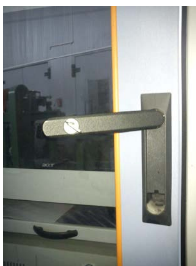
Рисунок 4 – Внешний вид замка на дверце электромонтажной стойки
