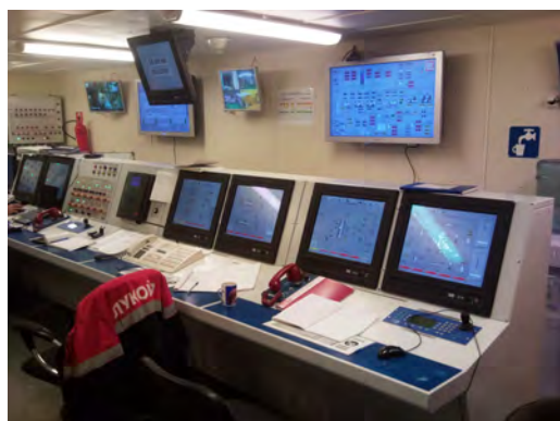
Центральный пульт управления
