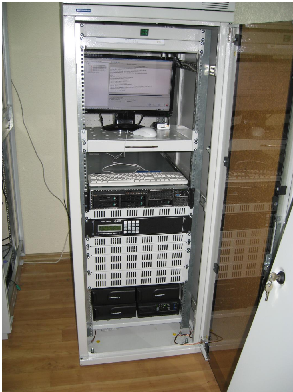
Внешний вид центрального сервера АИИС КУЭ МУП «ВОДОКАНАЛ» г. Ставрополь
