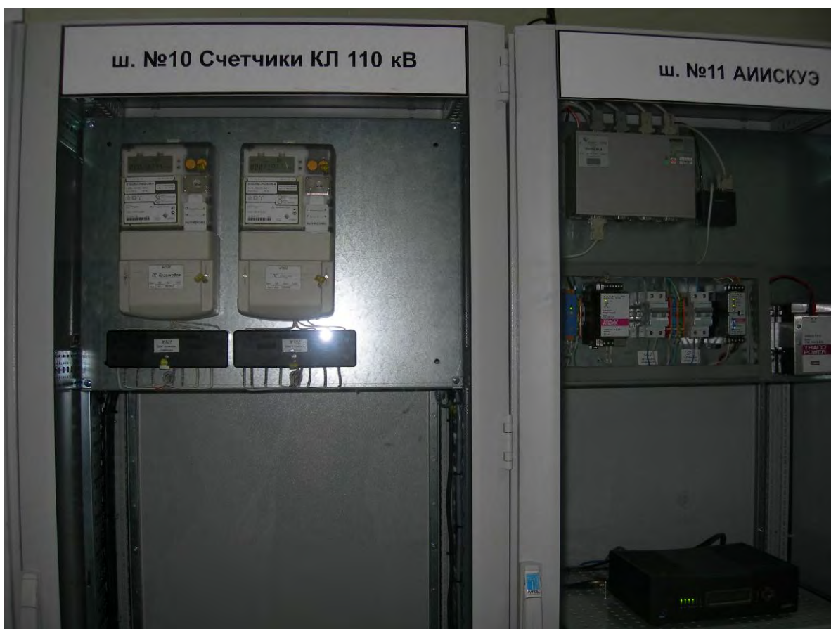
Общий вид основных составных частей АИИС КУЭ ПС 110 кВ «Роза – Хутор»
