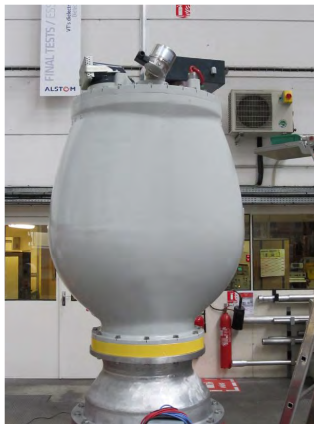
Внешний вид трансформаторов напряжения T155-VT3 и место пломбирования
