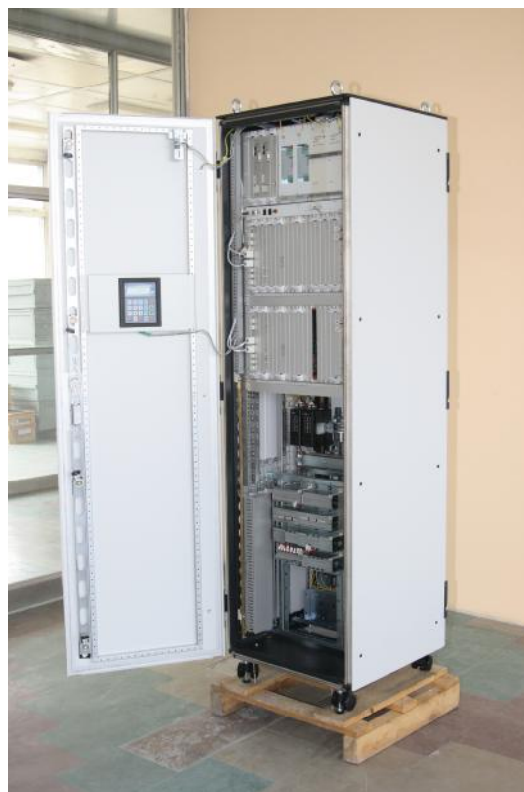
Рисунок 1 - Фотография общего вида шкафа управления комплексов программно-технических на базе ТСА М2002 и комплексов программно-технических на базе ТСА М2002М
