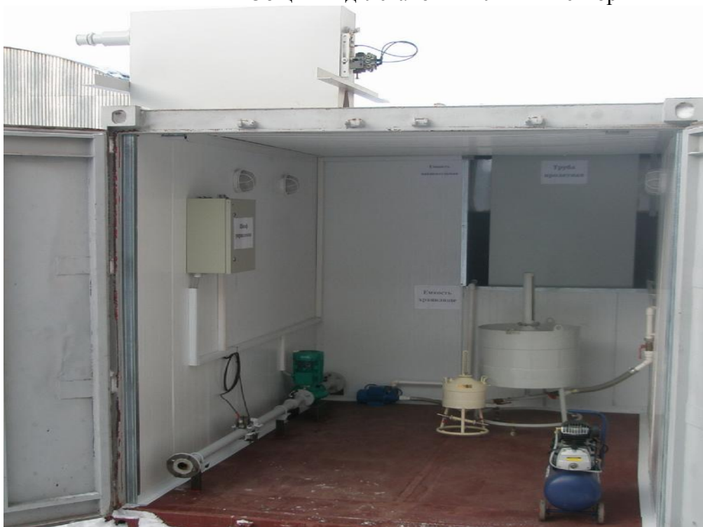
Общий вид Установки УПМ «Вектор»
