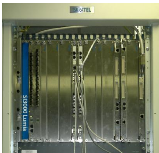
Рисунок 1 Общий вид оборудования с открытой дверью
