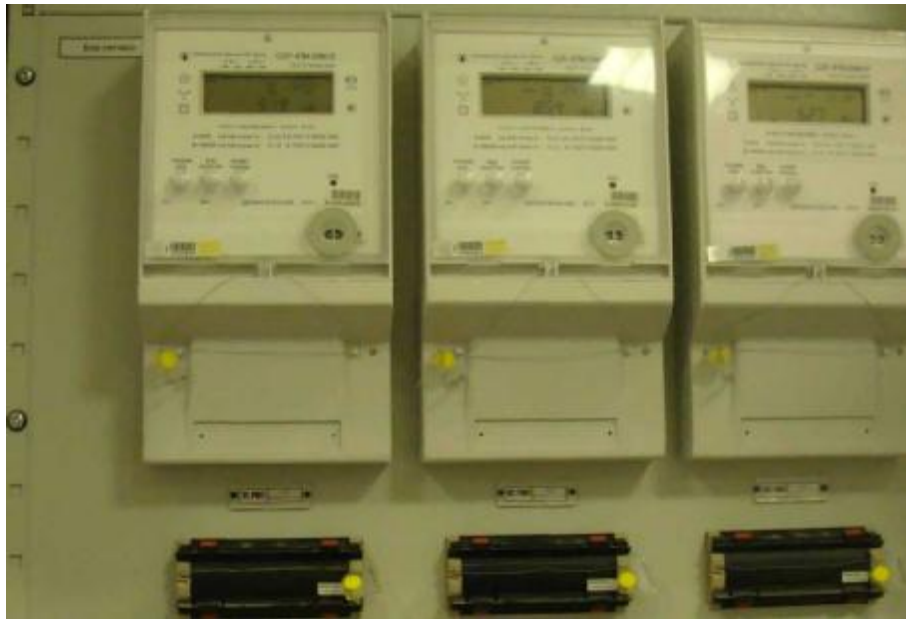
Рисунок 1 Общий вид счетчиков электрической энергии АИИС КУЭ
