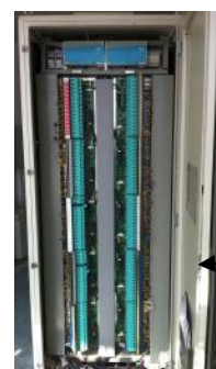
Шкаф с промежуточными преобразователями
