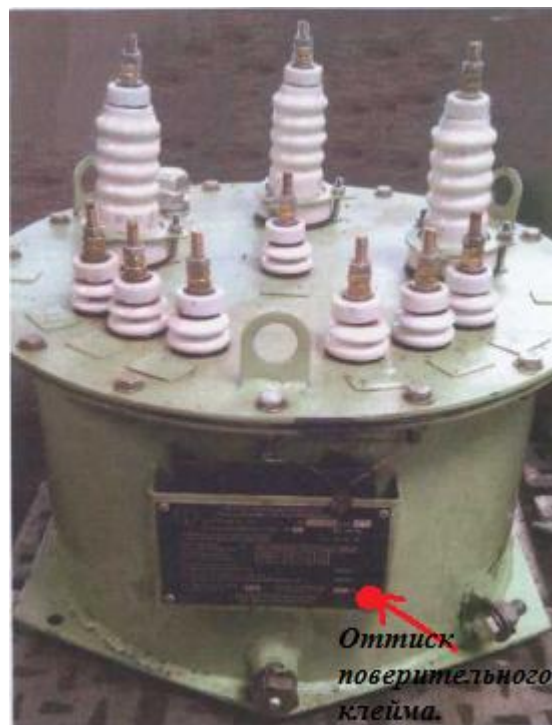
Рисунок 1 - Внешний вид трансформаторов.
