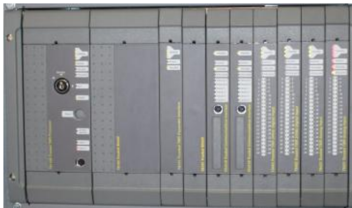
Общий вид контроллера с модулями ввода/вывода
