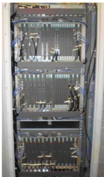
Рисунок 1 - Общий вид оборудования с открытой дверью
