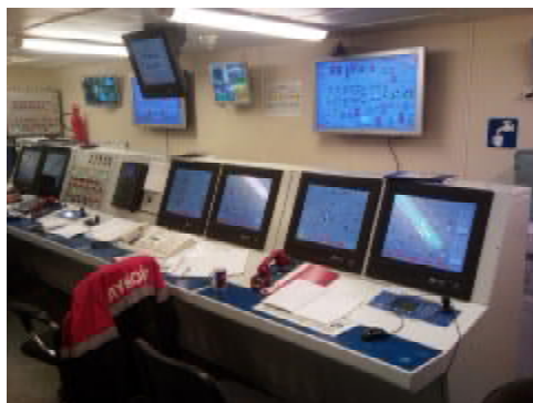
Центральный пульт управления
