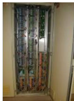
Шкаф с промежуточными преобразователями
