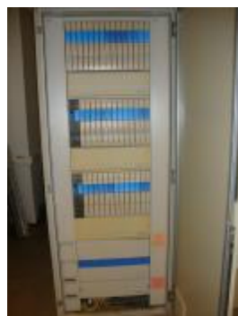
Шкаф с модулями ввода/вывода
