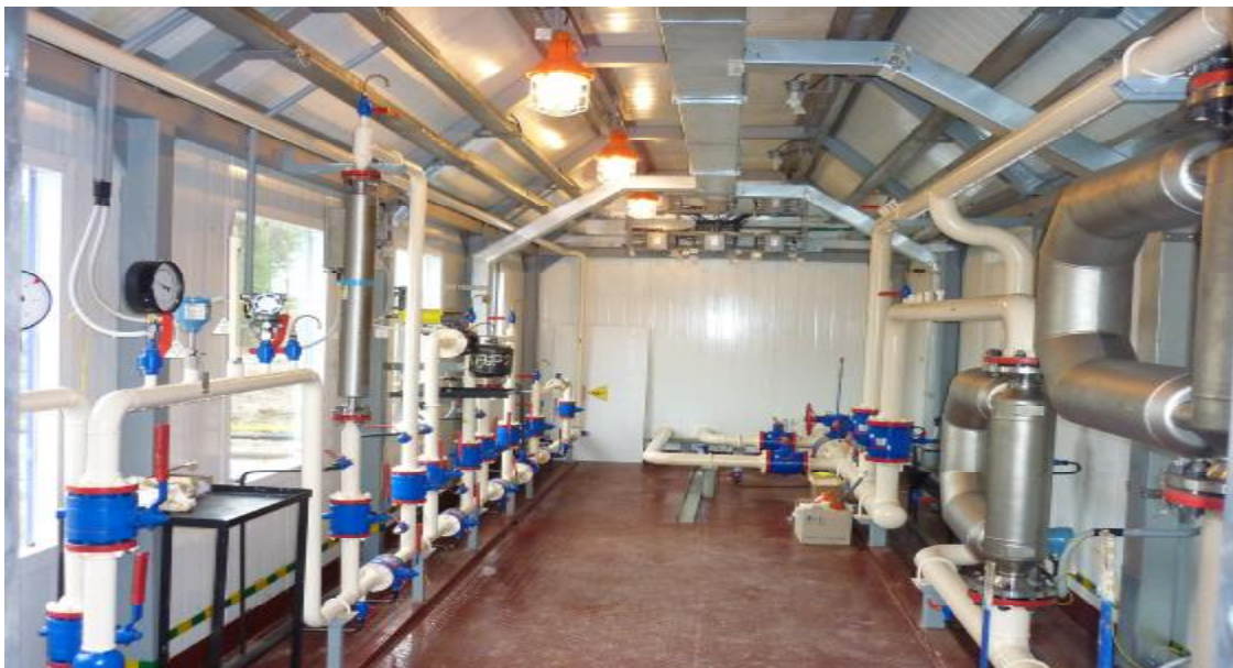
Фото 1 Общий вид СИКНС
