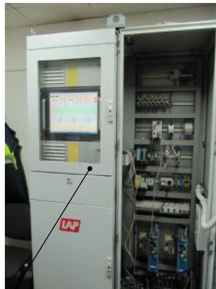
Рисунок 2 - Электрощкаф с компьютером
