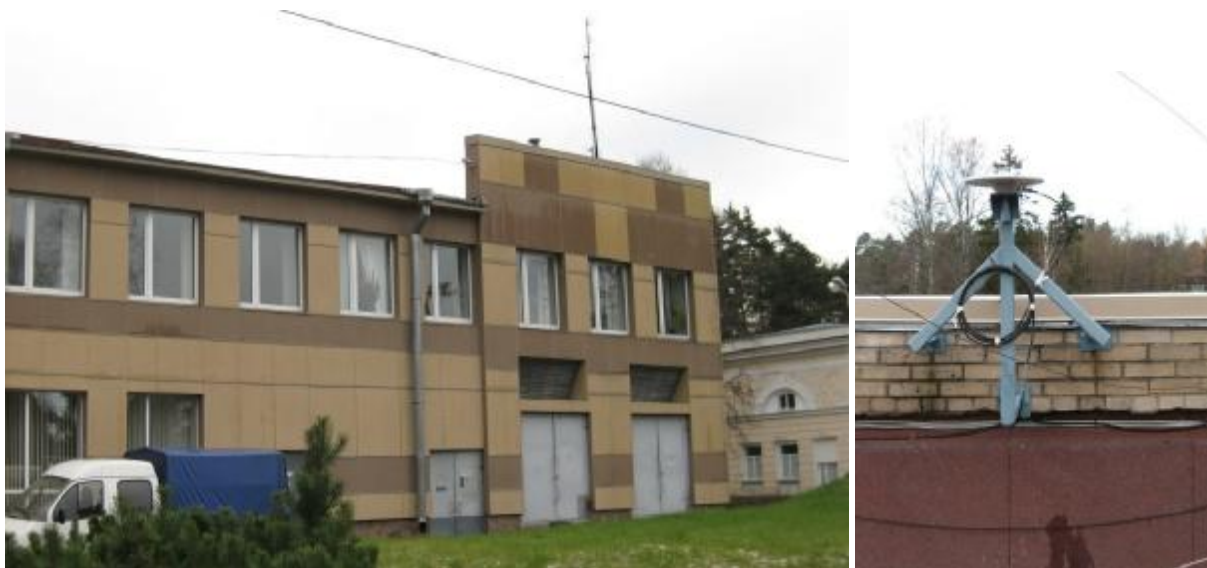
Рисунок 10 – Внешний вид реперного пункта, расположенного по адресу: г. Зеленогорск, ул. Кавалерийская, д. 4
