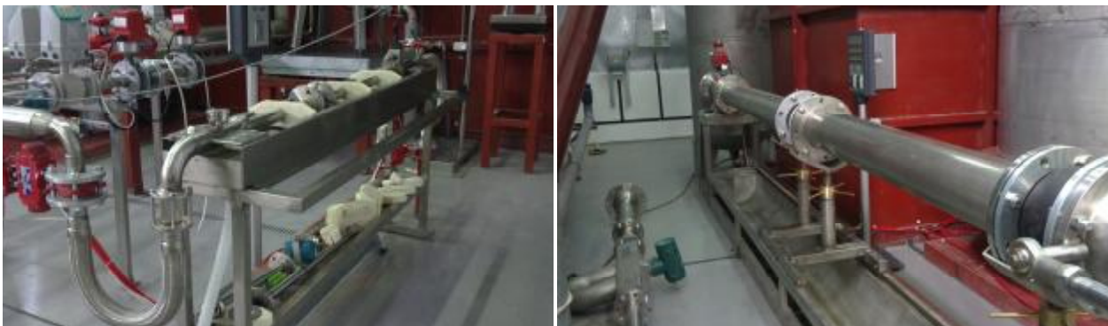
Рисунок 1 – Общий вид установки
