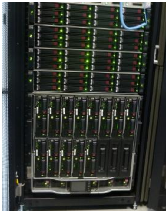
Рисунок 1 Общий вид оборудования с открытой дверью
