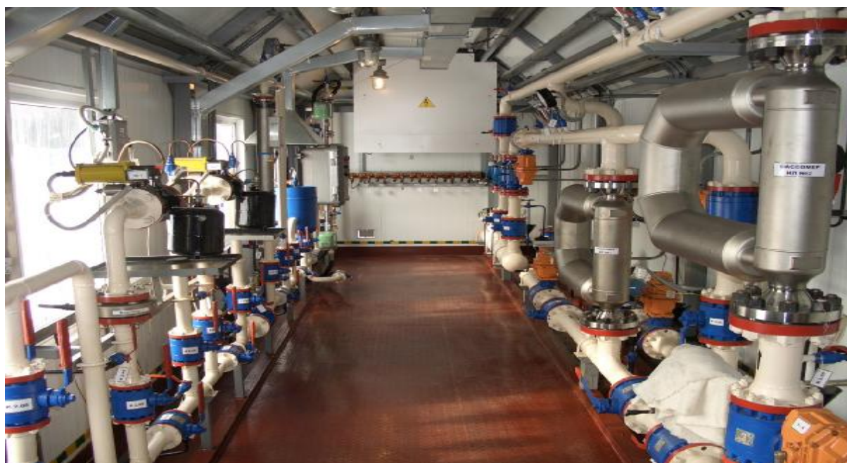
Фото 1 Общий вид СИКН
