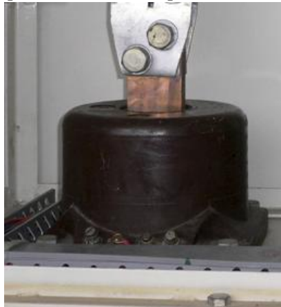
Рисунок 1 – Фотографии общего вида трансформаторов тока TSR-61.
