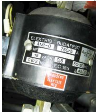
Рисунок 1 – Фотография общего вида трансформаторов тока Amt-0.
