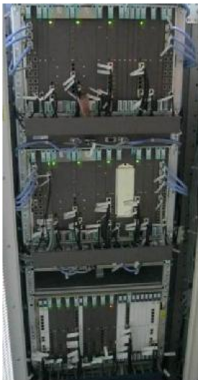
Рисунок 1 Общий вид оборудования с открытой дверью
